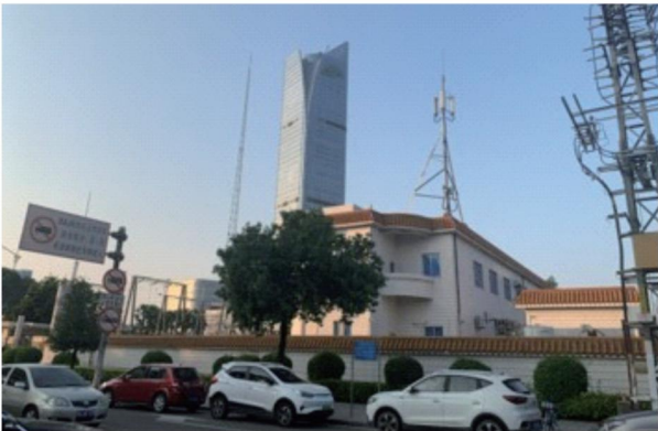
110千伏西平变电站
